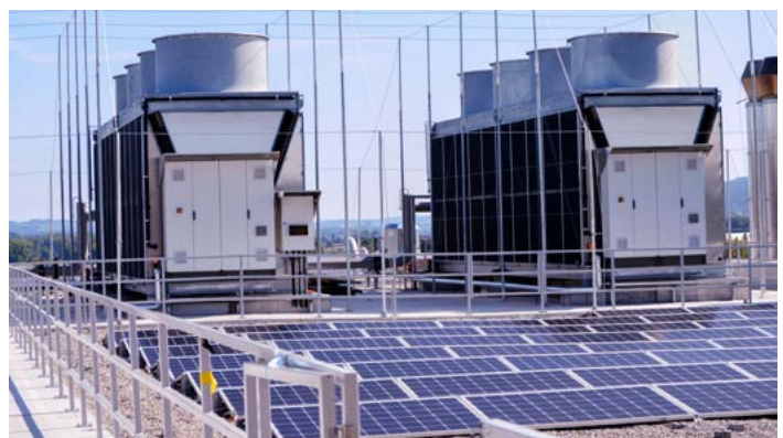
Kühlsysteme und Solaranlagen auf dem Dach des Modulbaus.
